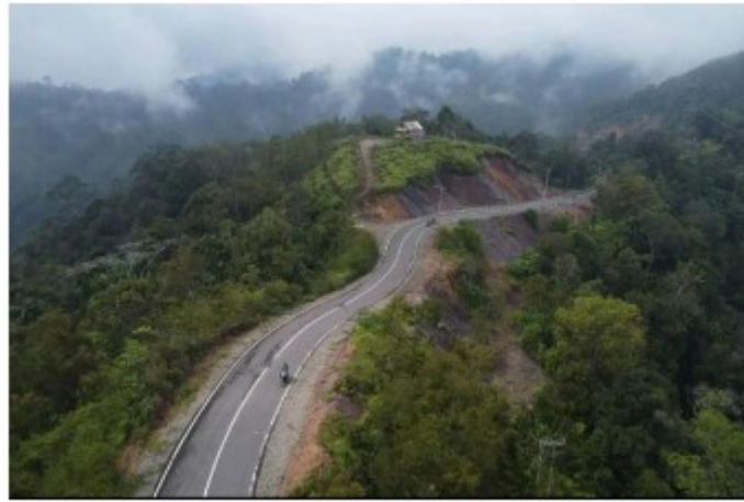
Kondisi pembangunan jalan di daerah Basse Sangtempe atau Bastem, kawasan dataran tinggi di Luwu. Foto: latimewis
