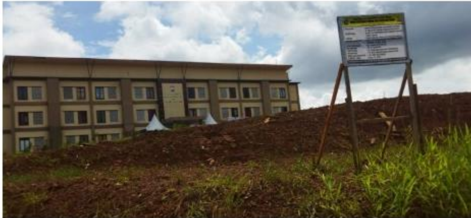
Lokasi pembangunan Mapolres Luwu Timur di Jalan Soekarno Hatta, Desa Puncak Indah, Malili/foto-Hery Rahmat
