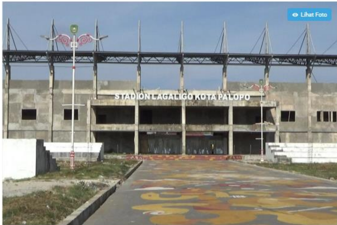
PROYEK MANGKRAK: Proyek Pembangunan Revitalisasi Stadion Lagaligo dan Penataan Landscape Stadion Lagaligo di Kelurahan Lagaligo, Kecamatan Wara Kota Palopo, Sulawesi Selatan (Sulsel) terlihat mangkrak, Jumat (20/9/2024) (KOMPAS.COM/AMRAN AMIR)
