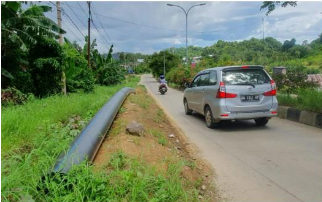
Kegiatan galian tanah proyek pembangunan jaringan perpipaan SPAM di jalur dua Jalan Sawerigading, Sengkang Kecamatan Tempe Kabupaten Wajo menguasai setengah jalan dan tanpa garis pengaman, Kamis, 18 April. (FOTO: IMAN SETIAWAN P/FAJAR)
