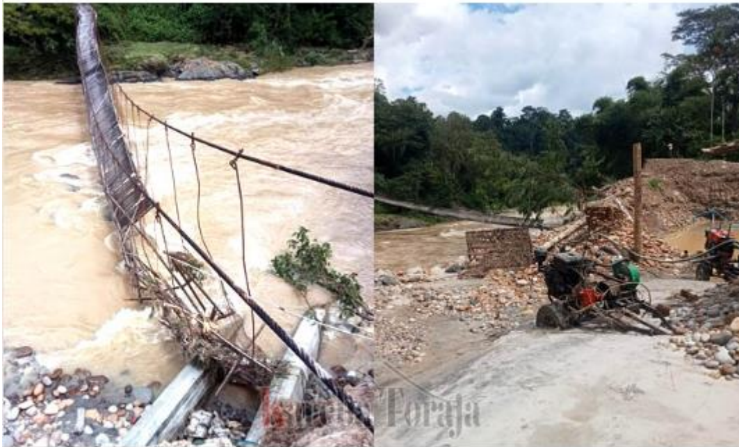
Jembatan gantung Karassik yang terletak di Dusun Ukka', Lembang Tapparan Utara, Kecamatan Rantetayo, ambruk dan rusak pada Jumat, 16 Februari 2024 malam. Di sampingnya nampak sejumlah mesin pengeruk pasir. (Foto: dok. istimewa).
