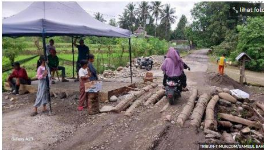
Warga lewati jalan dan jembatan rusak di Desa Anrang-Bulolohe, Kecamatan Rilau Ale, Kabupaten Bulukumba, Sulawesi Selatan, Sabtu (13/7/2024).
