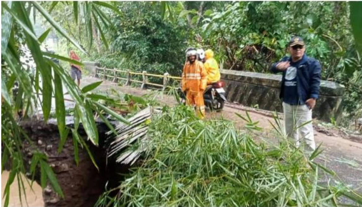
Ketfo: Camat Herlang Andi Fidya Samad saat terjun langsung meninjau lokasi jembatan ambruk dan sejumlah jalan rusak di wilayahnya
