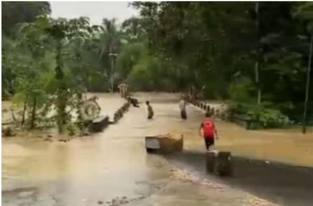
Camat Herlang Andi Fidy Samad saat terjun langsung meninjau lokasi jembatan ambruk dan sejumlah jalan rusak di wilayahnya (ist)
