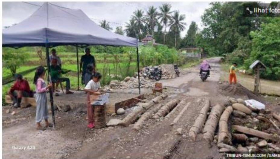
Warga Dusun Mattoangin, Desa Anrang, Kabupaten Bulukumba, Sulawesi Selatan, bahu-membahu membangun jembatan
