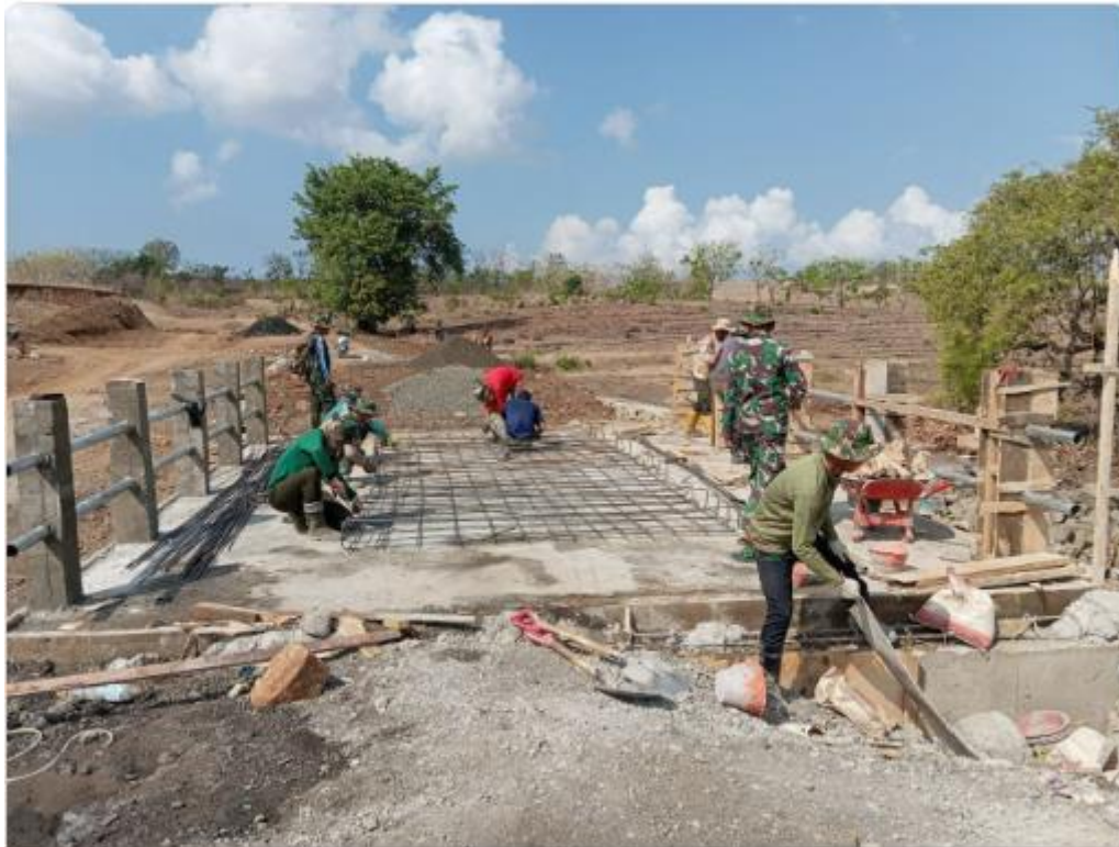
Pembuatan Jembatan di TMMD 122 Kodim 1425 Jeneponto di Desa Tuju Capai 80 Persen, Minggu (27/10/2024). (Foto. Istimewa)
