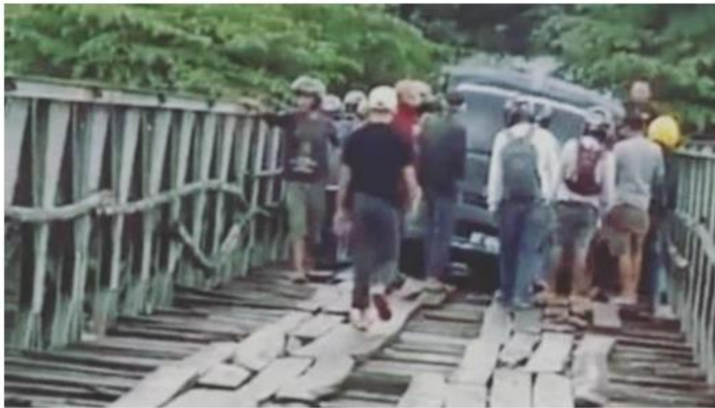
Mobil terperosok di jembatan penghubung desa bili-bili, Kabupaten Gowa. Foto: Dok. Istimewa
