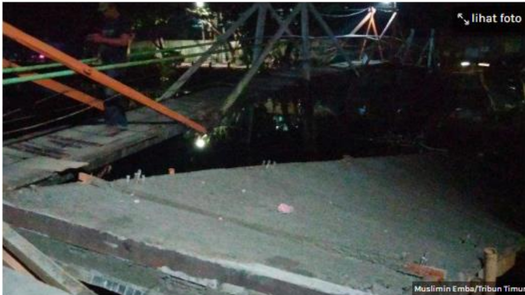
Jembatan penyeberangan di Jl Inspeksi Kanal Pampang, Kelurahan Pampang, Kecamatan Panakkukang, Kota Makassar, ambruk saat proses pengecoran, Rabu (23/10/2024) malam.
