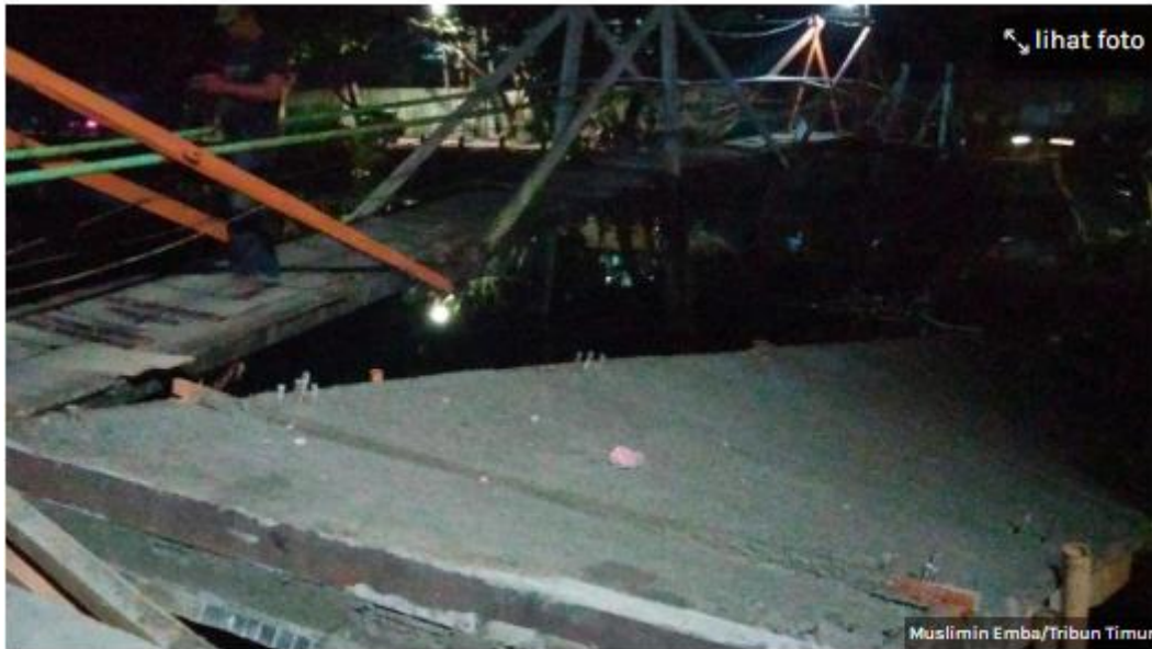
Jembatan penyeberangan di Jl Inspeksi Kanal Pampang, Kelurahan Pampang, Kecamatan Panakkukang, Kota Makassar, ambruk saat proses pengecoran, Rabu (23/10/2024) malam.
